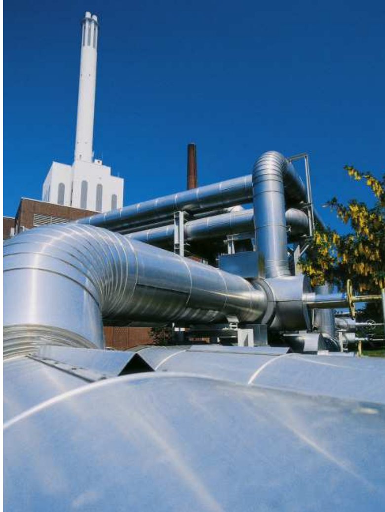
Das Heizkraftwerk Mitte wird um eine hocheffiziente Gas- und Dampfturbine ergänzt, deren Leistung das Ausbauprogramm für Fernwärme gewährleistet.
